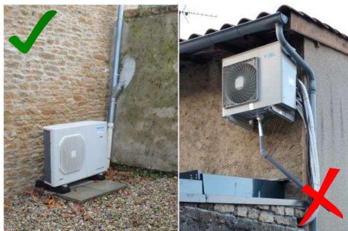
Climatisation cachée à l'abri des regards et mur faisant office de masque sonore
